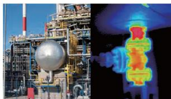
化学反応炉・異常発熱監視
